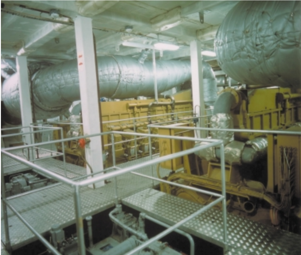
SALLE DES MACHINES DE L'AQUASTRADA TMV 115
